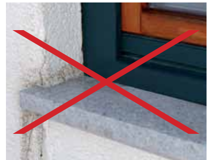
Falsch montierte Fensterbank
